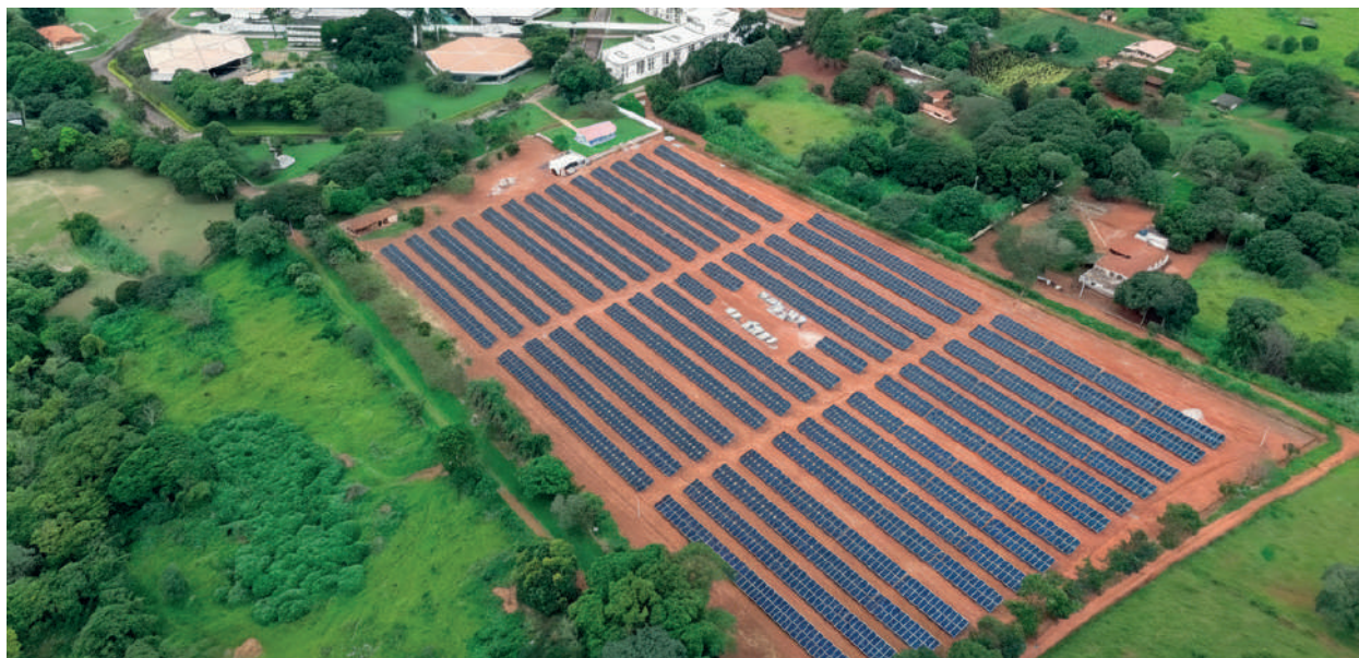
Imagem: Usina fotovoltaica Fonte: www.freepressjournal.in
